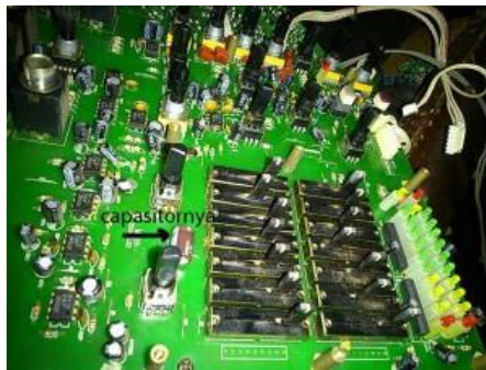
Gambar 162. Posisi kapasitor yang meledak
