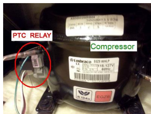
Gambar 27. PTC Relay pada kompresor
