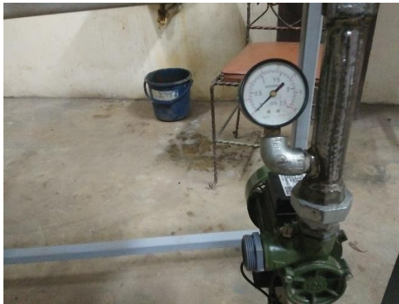
Gambar 5. Instalasi Pompa Air dan Pressure Gauge Pada Rangka Oil Filter Cleaner
