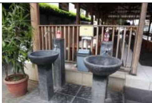
Gambar 5. Fasilitas Westafel di Pondok Bakaran Giwangan
