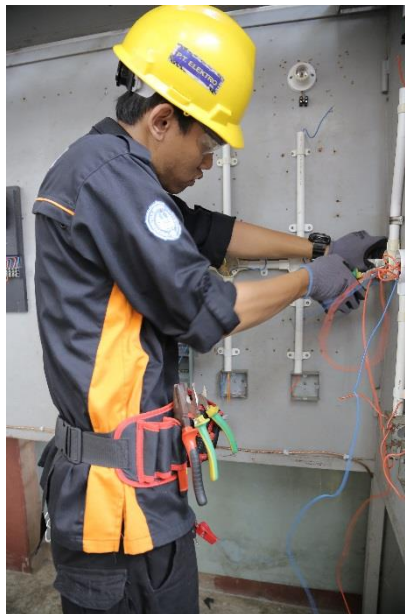
Gambar 30. Contoh aman instalasi kabel
