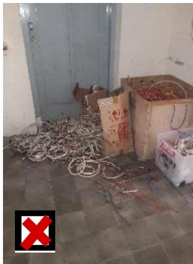
Gambar 22. Kabel tidak rapi
