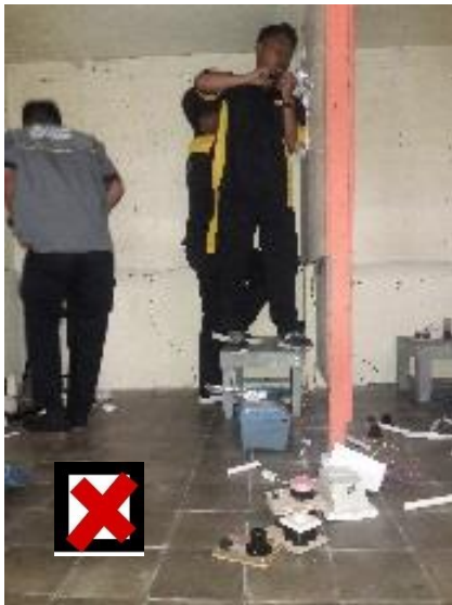
Gambar 6. Instalasi pipa berpijakan meja
