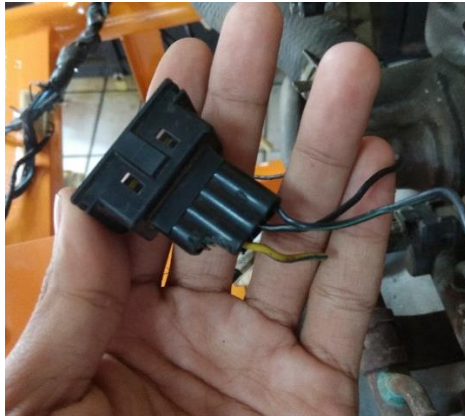
Gambar 1. Salah satu kerusakan pada jaringan kelistrikan
