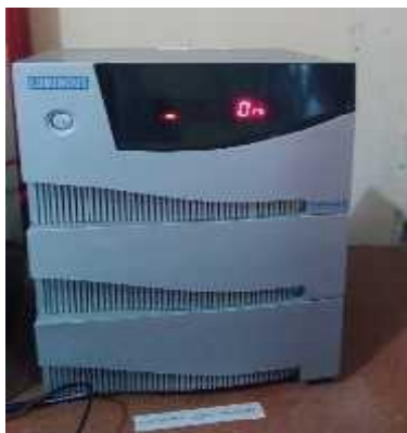
Gambar 7. Inverter di PLTH Bayu Baru
