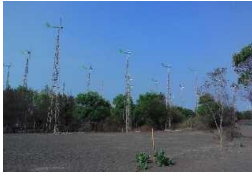
Gambar 6. Gambar Turbin Angin PLTH Bayu Baru
