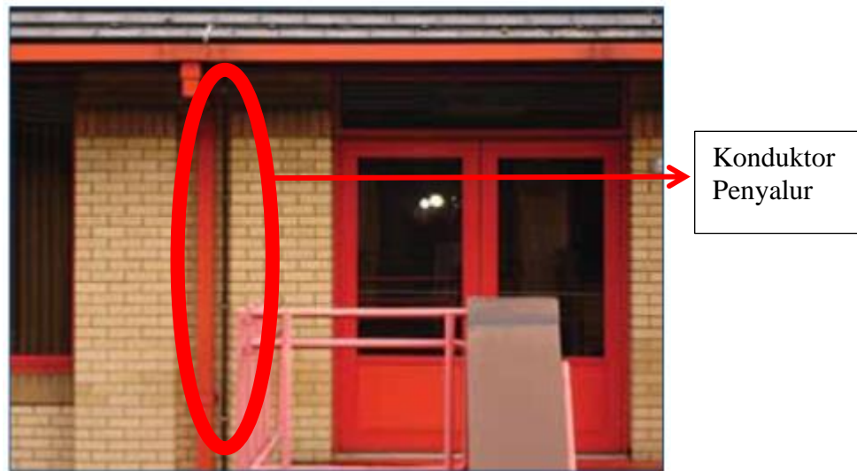
Gambar 7. Penempatan konduktor penyalur yang tidak baik
