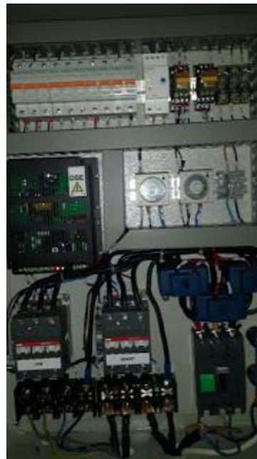
Gambar . Panel ATS AMF dengan menggunakan kontraktor
