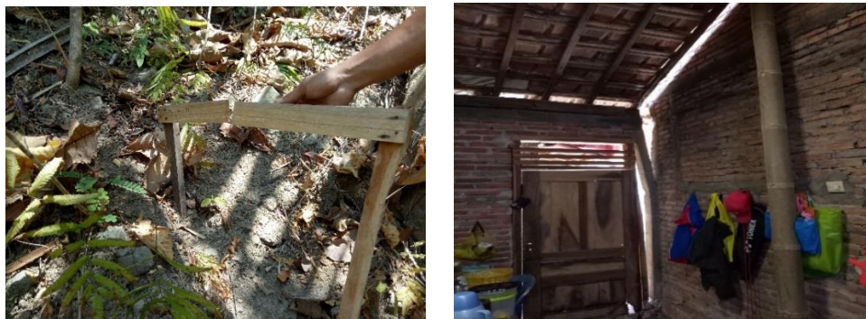
(a) (b) Gambar 2. (a) Rekahan yang terjadi di lereng bukit, (b) Rekahan yang terjadi di pemukiman warga
