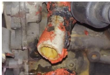
Gambar 1. Water Inlet Sebelum Diperbaiki
