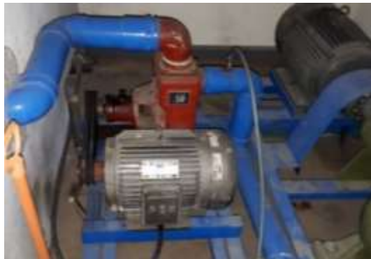
Gambar 17. Pompa Air (Sumber: Dokumentasi Pribadi, 2019)
