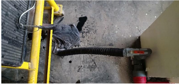
Gambar 12. Menguji kandungan gas sekitar engine stand sebelum menggunakan sistem instalasi gas buang
