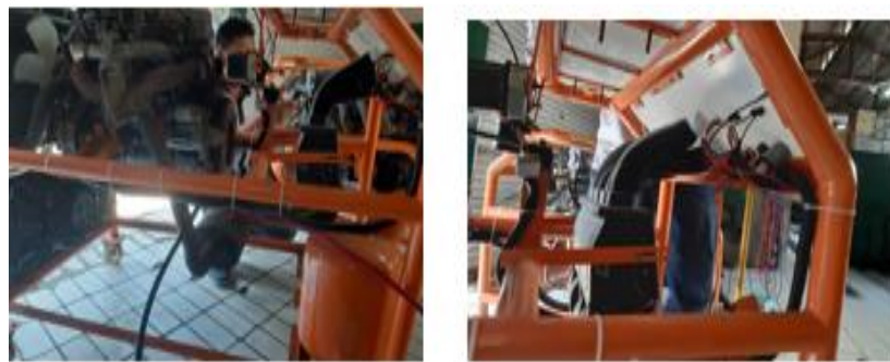
Gambar 55. Jaringan Kabel pada Engine Stand yang Baru
