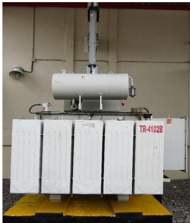
Gambar 13. Tansformator TR 4102 B
