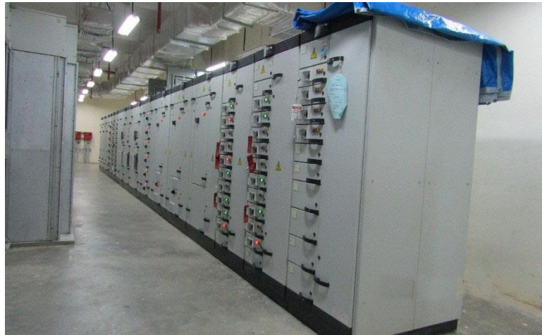
Gambar 18. LV SWGR 0.4 kV & MCC 4112 A/B
