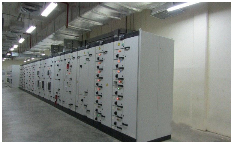
Gambar 17. LV SWGR 0.4 KV & MCC 4111 A/B
