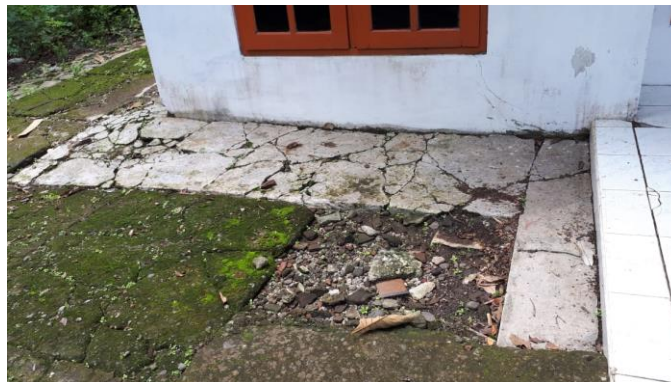
Gambar 1. Tanah lempung merusak bagian bangunan
