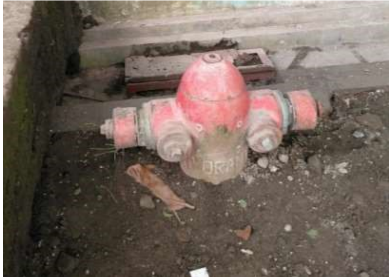
Gambar 31. Hydrant (Sumber: Pengamatan lapangan, 2019)
