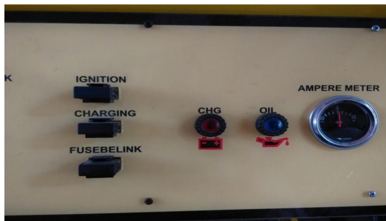
Gambar 35. Pengaplikasian fuse box , lampu indikator, dan ampermeter pada dashboard
