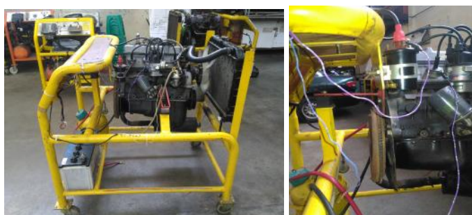
Gambar 36. Kondisi Kabel Rangkaian Kelistrikan
