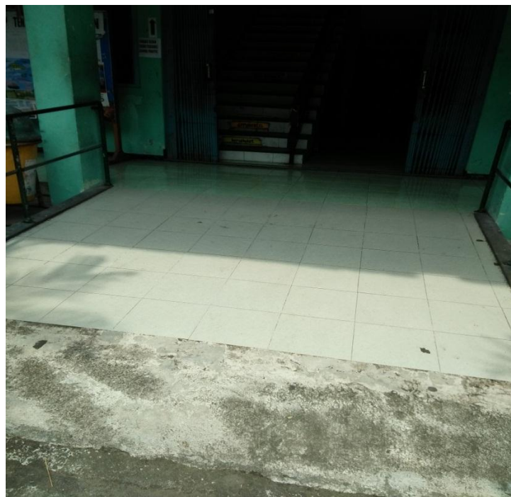
Gambar 11. Kondisi Jalan landau Menuju Halaman Sekolah Dasar Taman Muda Ibu Pawiyatan
