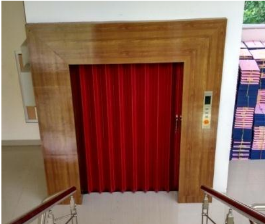
Foto 1. Kondisi lift kantor BKD Provinsi DIY
