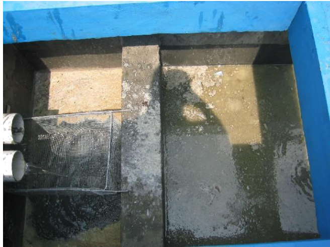
Gambar 2. Bak Pemisah Lemak di IPAL yang dilengkapi keranjang penahan sampah
