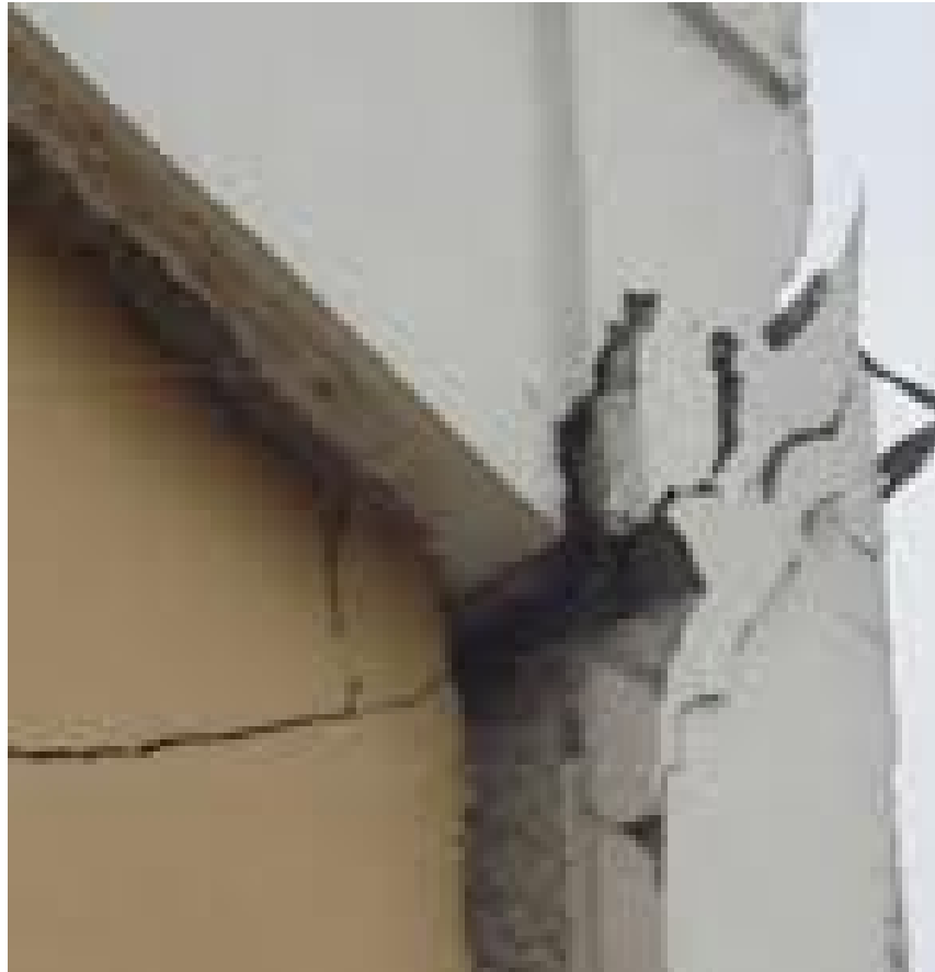
Kerusakan Hubungan Kolom Balok akibat Penurunan Pondasi
