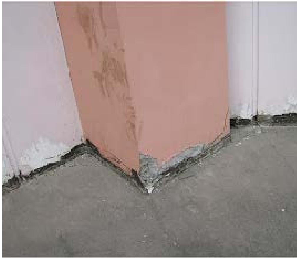
Kerusakan Hubungan Kolom , Dinding dan Lantai akibat Penurunan Pondasi
