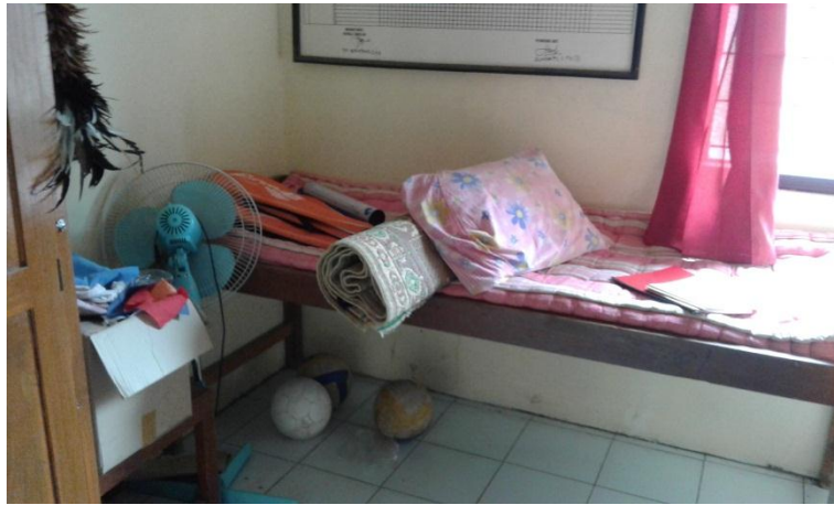
Gambar 1. Ruang UKS yang tidak terawat dan jadi satu dengan tempat Penyimpanan peralatan olahraga.
