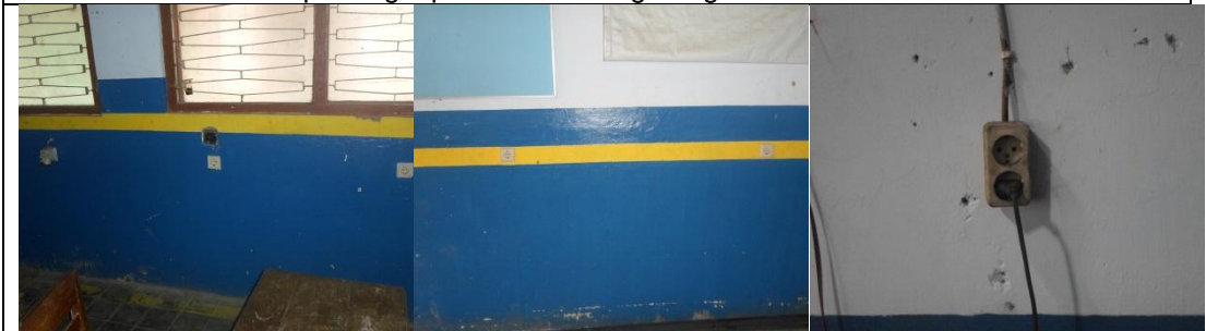
Perlengkapan lain berupa kontak-kontak listrik di ruang bengkel TSM
