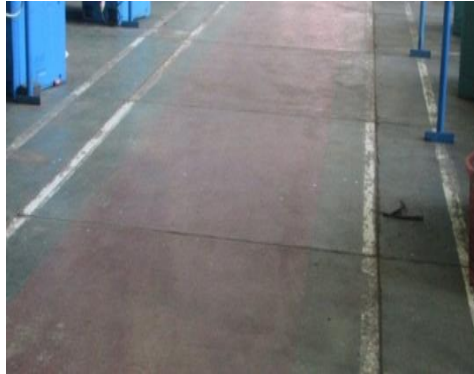
Gambar 9. Kondisi lantai bengkel pemesinan
