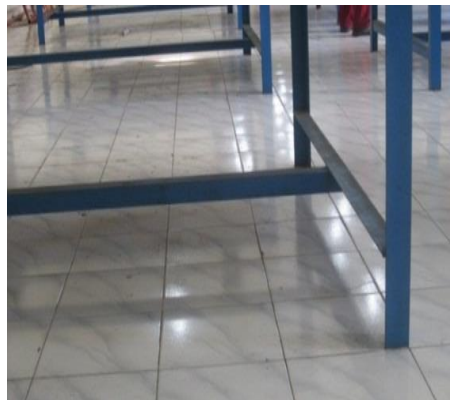
Gambar 10. Kondisi Lantai Bengkel Kerja Bangku
