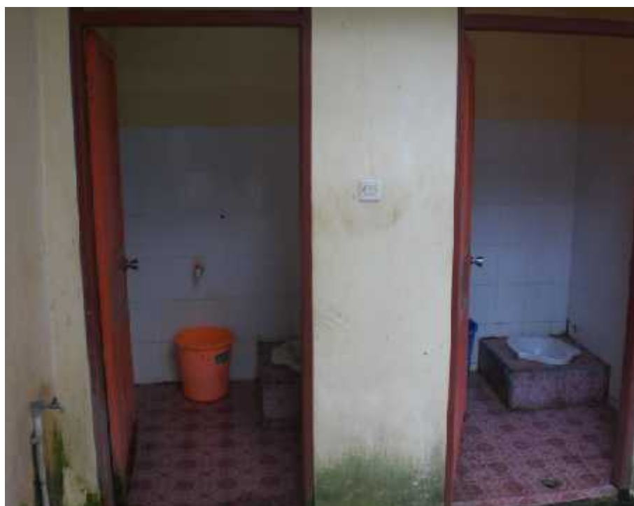
Gambar 16. Fasilitas air bersih dan Toilet
