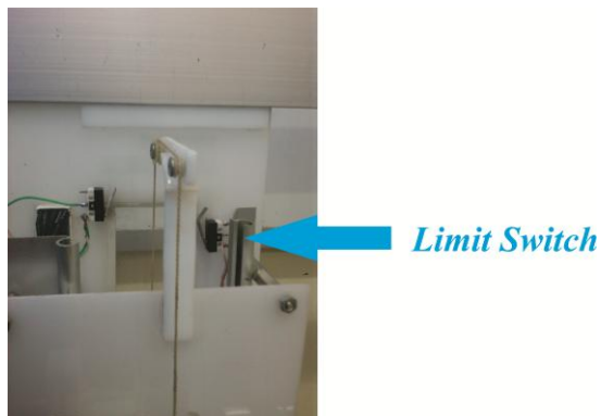
Gambar78. Letak pemasangan limit switch lantai tiga (tampak belakang)
