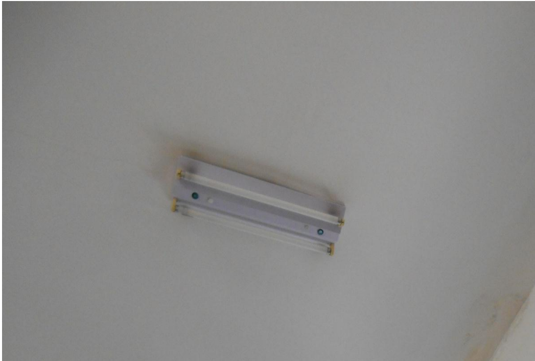
Sumber penerangan menggunakan lampu bolam dengan desain penerangan secara langsung
