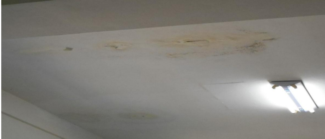
Kondisi Cat Tembok yang mengelupas dan berjamur
