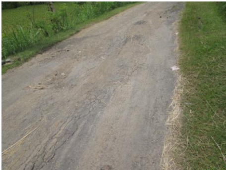
Gambar. Jalan rusak berat
